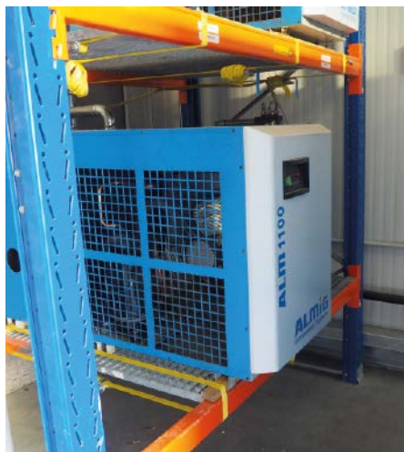
Abb. 3: Der externe, Kältetrockner: Seine Kennwerte sind an die jeweilige Anlage exakt angepasst.
