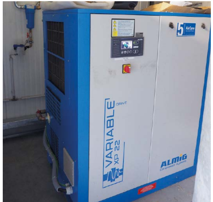
Abb. 2: Der Variable XP ist in Schwachlastphasen im Einsatz – z.B. nachts oder an den Wochenenden.
