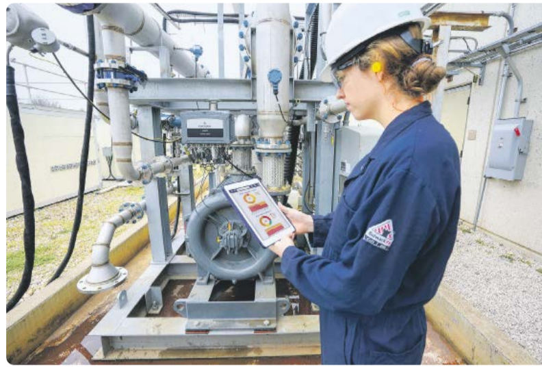
Bei der Durchführung einer routenbasierten Vibrationsüberwachung von Geräten können Außendiensttechniker das in das Handheld-Gerät eingebettete Fachwissen nutzen und durch zusätzliche Analysen geführt werden.
