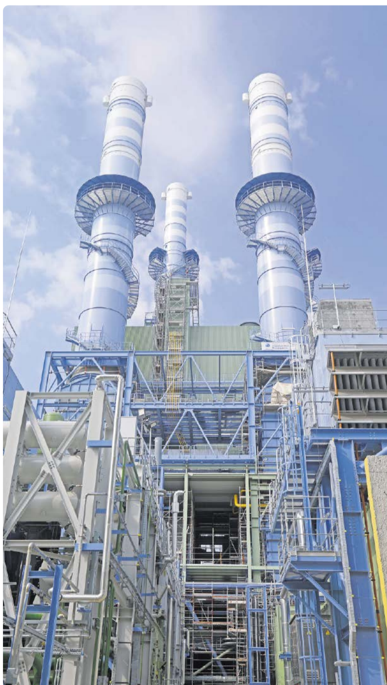
Infraser Höchst investiert einen dreistelligen Millionenbetrag in Gasturbinenanlagen.
