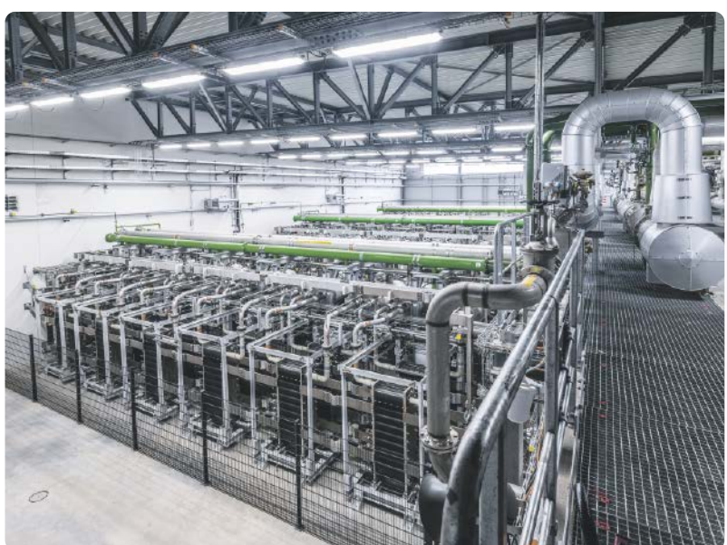
Insgesamt 72 Stacks umfasst der Elektrolyseur am BASF-Standort Ludwigshafen. In drei sogenannten Arrays sind die einzelnen Elektrolysemodule miteinander und mit dem H 2 -Verbundnetz am Standort verknüpft.
